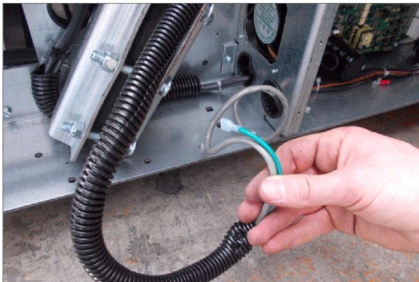
Abb. 23 Montage Mercury/Path, Anschluss 1
